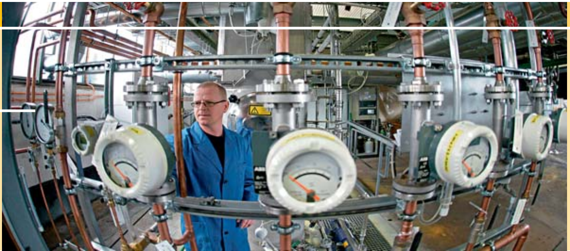
Abb. 25 Blick in die Oxyfuel Testanlage. Foto: Vattenfall Europe AG
